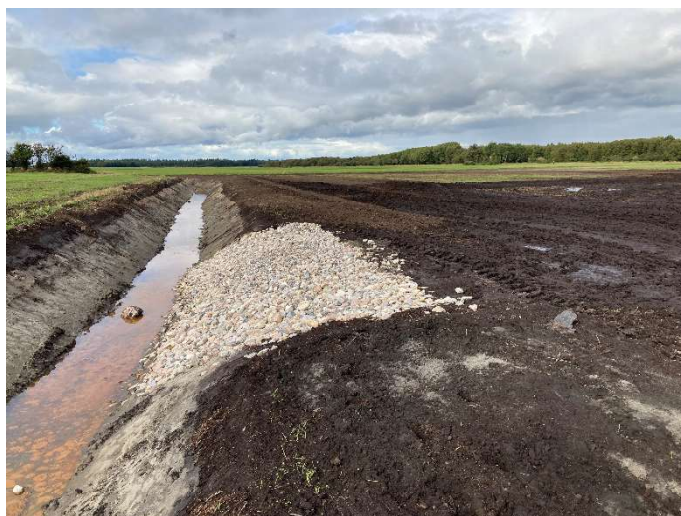
Figur 4-5: Eksempel på etableret overløbskarm til håndtering af overfladisk afstrømning.
