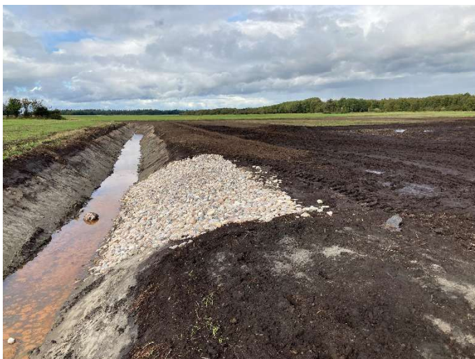
Figur 8: Eksempel på etableret overløbskarm til håndtering af overfladisk afstrømning.
